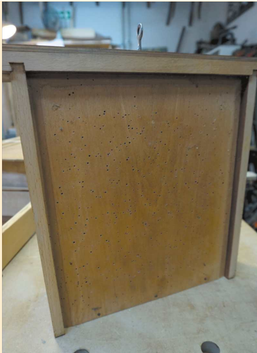
14. Całkowicie zniszczone przez owady sklejkowe denko szuflady
